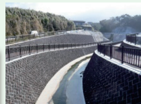
大金沢流路工
