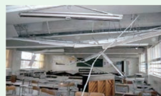
非構造部材落下事例
