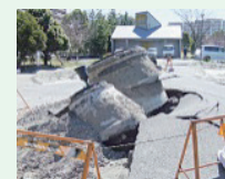
液状化によるマンホールの浮上
