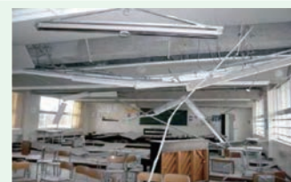
非構造部材落下事例
